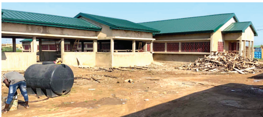
Le taux d'exécution des travaux du centre médical était à 75% lors de la visite.
